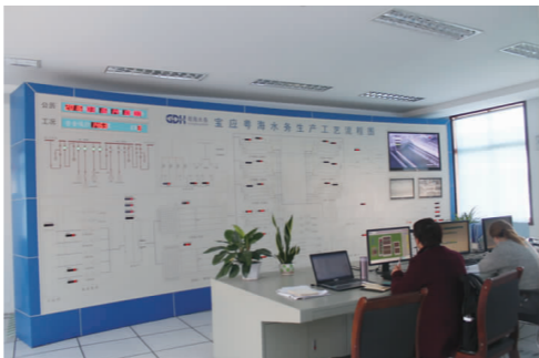
粤海水务监控室
