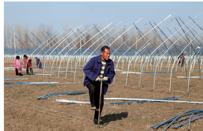
望直港镇把发展设施农业作为转变传统农业生产方式、发展现代农业的重要工作来抓,大力推进,积极推广,2017年该镇将围绕安大线新建一个设施农业基地。图为牌楼村村民正在搭建大棚。
