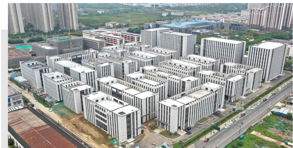
日前,联东U谷·常州智能制造科技园项目正加紧施工,目前项目一期18栋高标准厂房已建成,二期6栋厂房进入涂料施工阶段,同时园区正加速推进绿化设施铺设工作。项目预计今年11月底基本完工,年内完成竣工验收工作。徐梦超 徐千翥 摄
