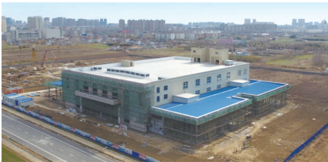
振东汽车广场项目 ,总投资2.3亿元,建筑面积6.05万平方米,入驻16家4S店,从事汽车销售、维修保养等一条龙服务。目前,1号楼已基本竣工,3号楼开工建设,2018年上半年全面运营。
