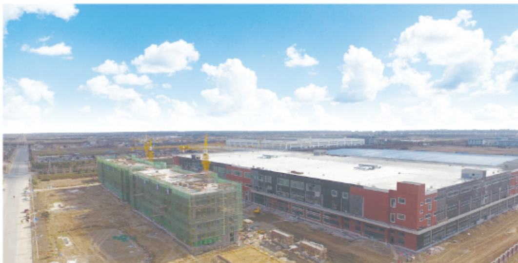
海聆梦智能家居产业项目 ,总投资5亿元,引进SAP信息网络化管理系统和先进的自动化生产线,实现国内外家居产品一体化个性定制和多品种批量生产。目前,8万平方米厂房已竣工,部分设备进场安装。
