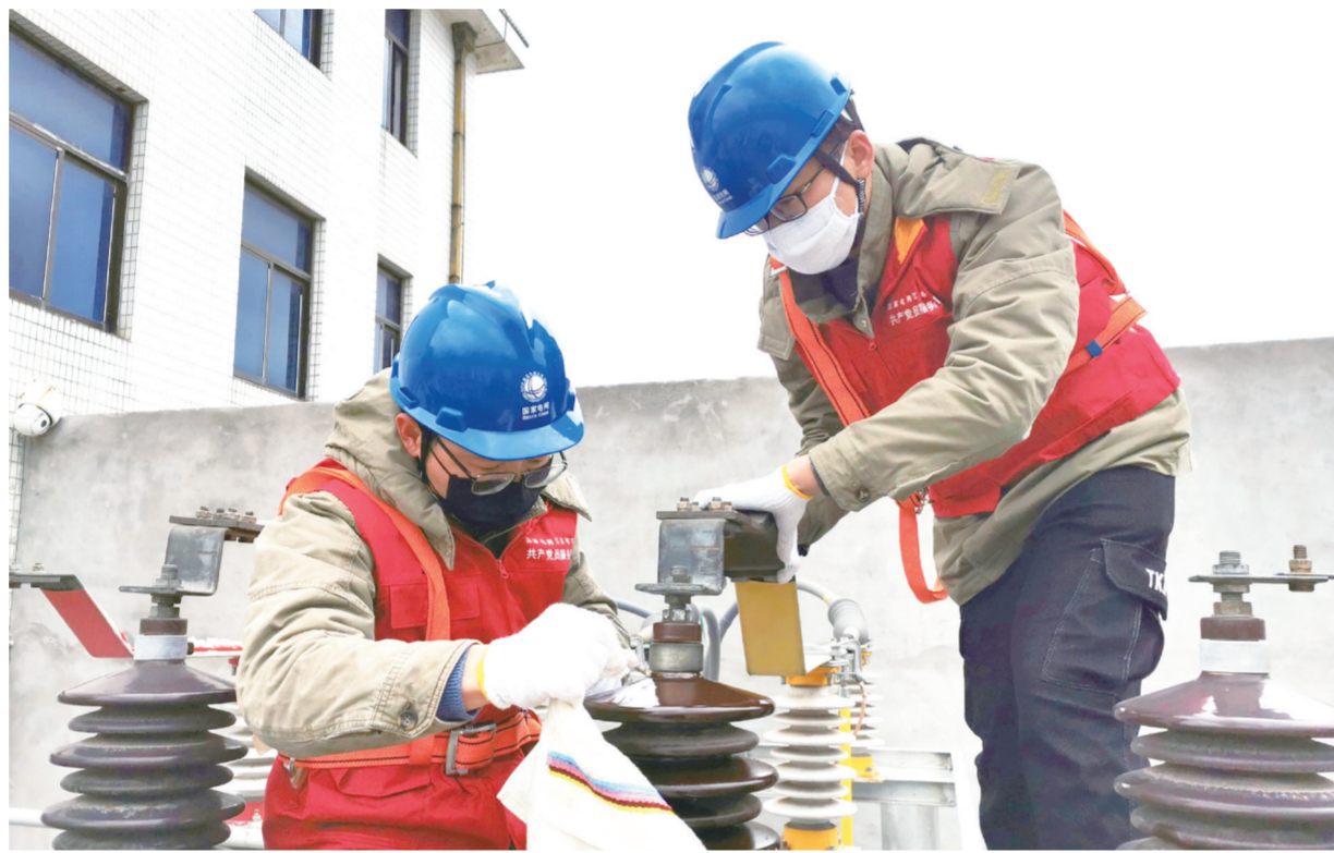
2月13日,在大丰经济开发区35千伏城西变电站,电力人员正对设备故障实施抢修作业。当天,区供电公司变电运行人员在巡查城西变电站发现2号主变高压侧A相套管出现漏油,将严重影响设备安全运行。该公司输变电运检中心迅速组织党员突击队赶赴现场,抢修漏油故障,为辖区内企业、居民的正常供电提供安全保障。 邱鹏 陈红兵 摄
