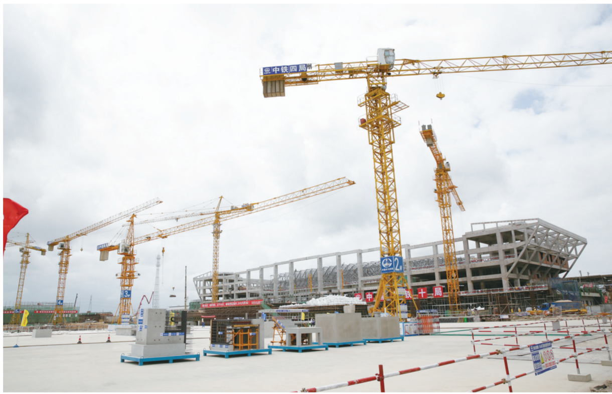
近日,大丰高铁站前广场项目现场,施工队在紧张施工。该项目包括景观广场、站南路、站北路、架空落客平台、地下停车场、交通换乘中心综合楼等配套设施。目前,地下停车场及地面建筑基础工程已经完成,全部工程量完成了70%。万成摄
