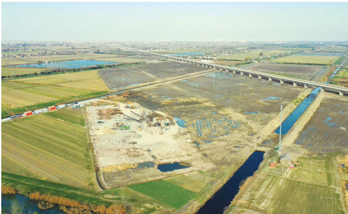
近日,白驹镇民窑村高铁沿线环境整治施工现场,工作人员对高铁项目部制梁场临时用地进行复垦。近年来,我区围绕农房改善、村庄环境、土地复垦、安全隐患排查等重点工作,对境内47公里高铁沿线开展环境整治,着力打造美丽高铁风景线。 单培泉 摄
