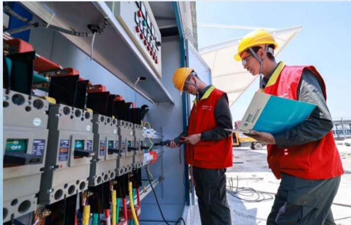
电力红船党员服务队检查即将投运的公交站充电桩配套电力设施，保障绿色交通体系建设。(蔡俊 摄)
