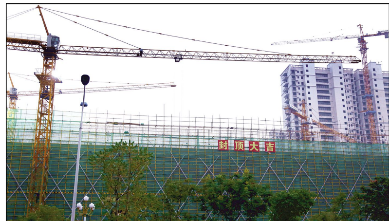
近日,我区万达广场项目主体结构已经完工,顺利封顶,预计2019年12月对外正式营业。李文君 摄
