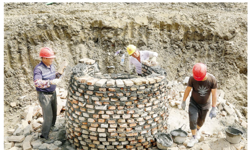
南翼路（西长街-南门大街）建设工程全长357米，路宽41米，标准路宽37米，工程造价1118.19万元。该工程5月24日开工，预计年底竣工。图为现场进行排水系统施工。
