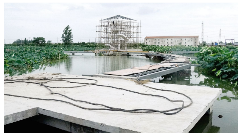
流均镇都梁村是我区农村居住空间规划中11个特色保护型村庄之一，去年以来，该村围绕建筑修缮、景观绿化、基础设施、污水处理等方面对村庄实施整治提升改造。图为该村正在铺设中的600米藕田观光栈道和观景台。
