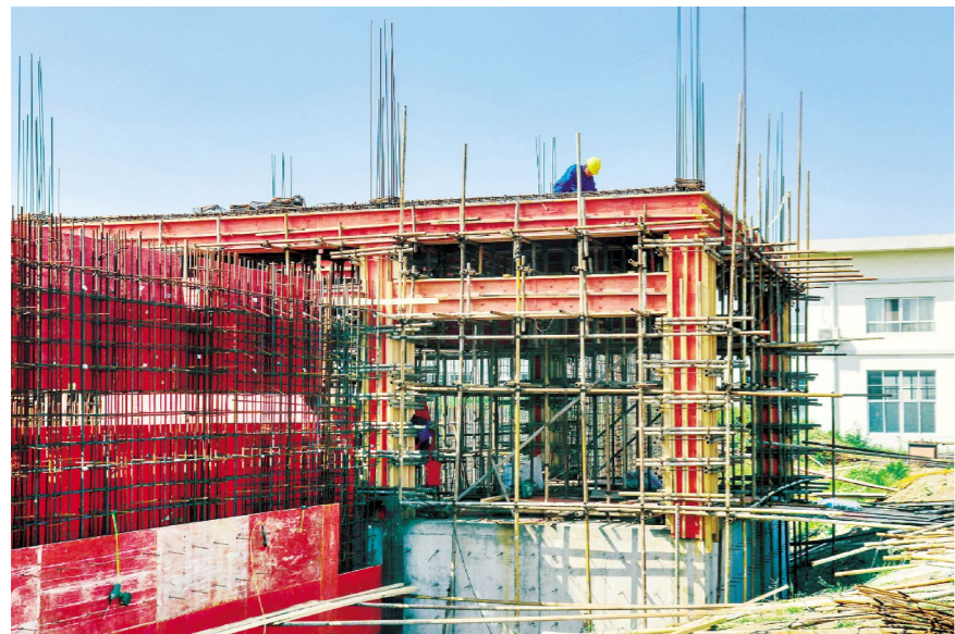
白马湖水厂二期扩建工程于2019年5月30日开工建设，计划年底前投入运行。该工程建成后将增加日供水能力8万吨，届时白马湖水厂的日供水能力将达到13万吨，供水范围将涉及全区24万户，全面覆盖渠南、渠北、运西、省属白马湖农场及苏淮高新区。 朱士新 摄
