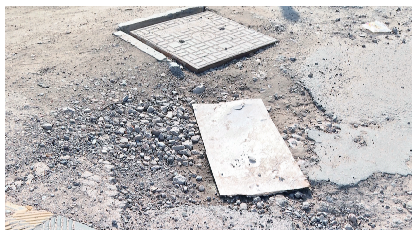
破碎坑洼的路面。
