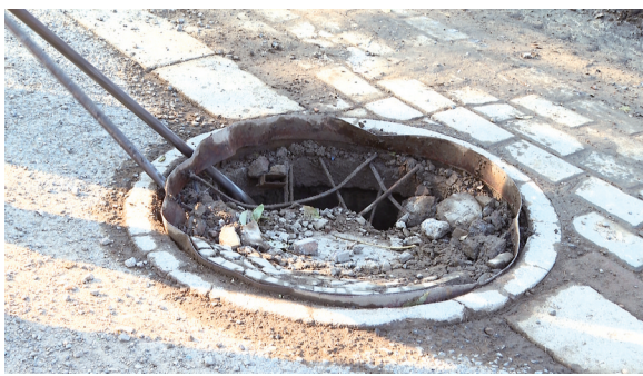
窨井盖破损严重。
