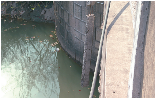
栏杆断裂后悬挂在桥体。
