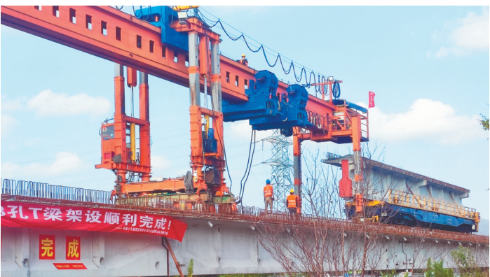
8月8日,中铁路十九局洋吕铁路2标项目1373孔T梁架设全部完成,为洋吕铁路按期通车运营提供有力保障。洋吕铁路是我省第一条百亿级地方铁路,也是打造江苏新出海口、完善集疏运体系的关键工程。 张旭照 摄
