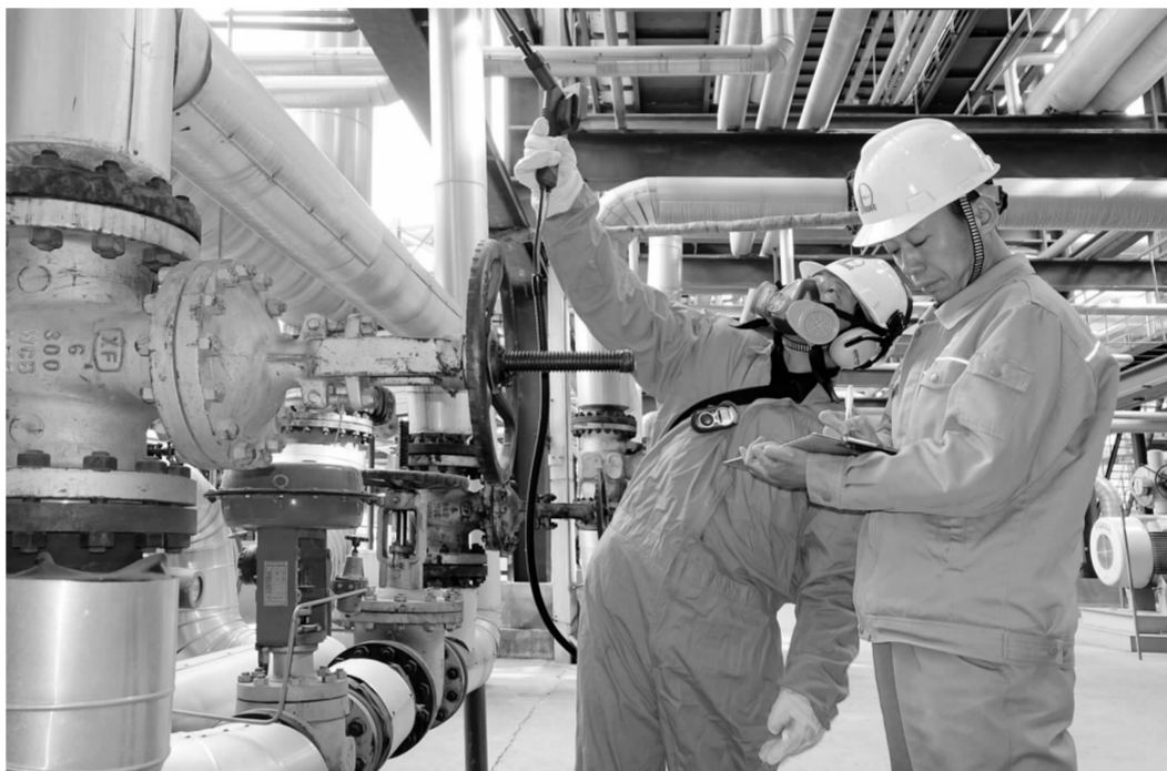
金陵石化公司强化装置现场运行管理,严格控制污染物排放,仅2-3月份就完成了近两万个隐形漏点的检测,让隐形泄漏无处可逃。
