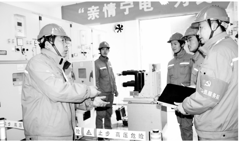
图为南京供电公司石城供电抢修服务队队长张代飏(左一)带队巡检。
