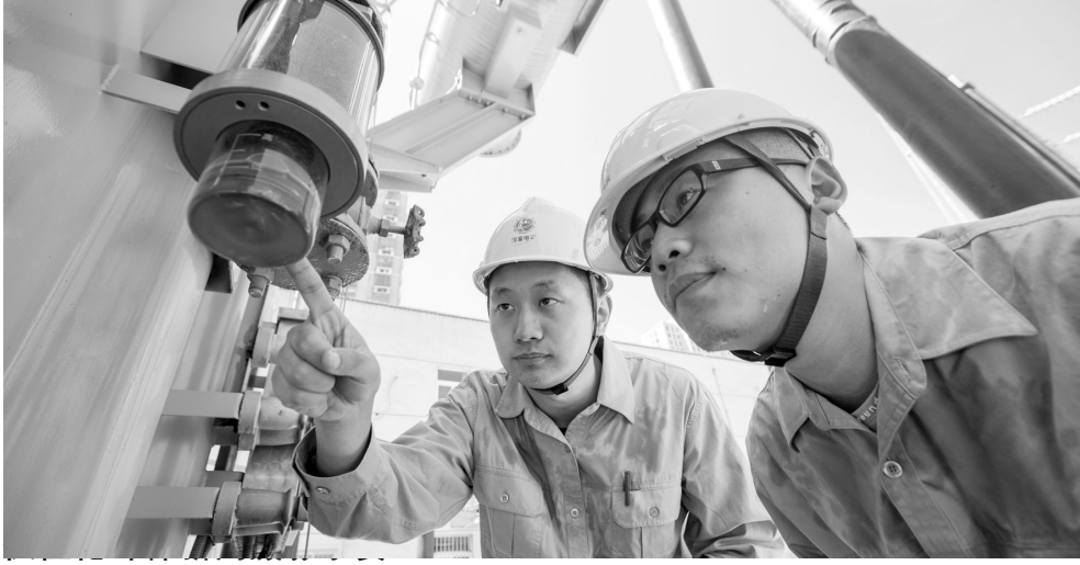
近日,国网常州供电公司运维值班员对110千伏北郊变电站进行专业巡视,检查主变压器、开关等主要设备的油温油位和气体压力状态,确保电力设备在迎峰度夏期间安全稳定运行。 黄正芳 吴文龙 摄
