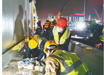
顾建兵(中立者)检查雷神山医院病房区排水管道安装情况
