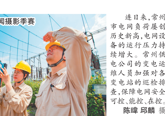
连日来, 常州市电网负荷屡创历史新高, 电网设备的运行压力持续增大。常州供电公司变电运维人员加强对各变电站的巡检排查, 保障电网安全可控、能控、在控。 陈晖 邱麟 摄
