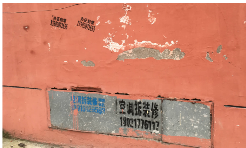
零星散落在莲花小区住宅楼的外墙
