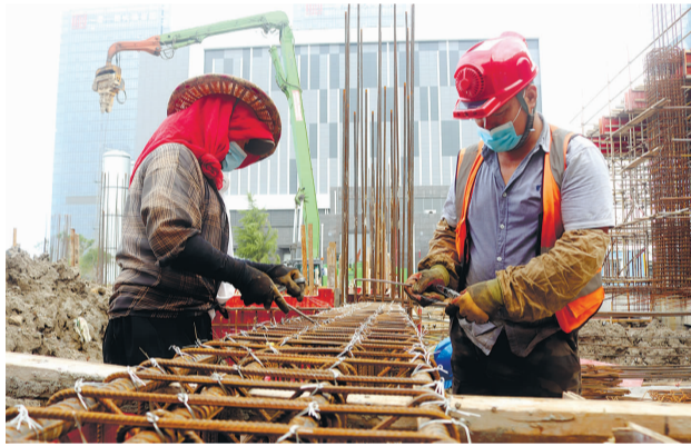
连日来，连云港持续高温，海州湾发展集团实施错峰施工，加强工程管理，努力保障市区级重点项目有序推进。图为中国电信（连云港）天翼云中心一期工程项目建设现场，施工人员正抓紧支模板、绑钢筋。
