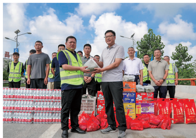
日前,东海县交通运输局组织局工会、公路港航科、质监等部门相关负责人赴310国道养护大修、战备路改建工程等重点交通项目工地,慰问坚守项目建设一线的工作人员。图为他们慰问现场。(李娟)
