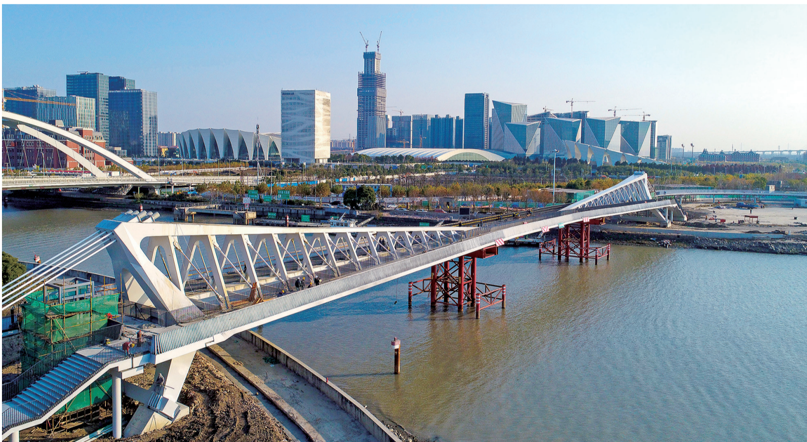
图为川杨河桥现场,施工人员进行油漆作业。 □本报记者 朱泉春 摄
