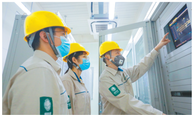
位于临港的110千伏数字孪生变电站日前正式投运,工作人员为其保驾护航。 □浦东供电公司 供图
