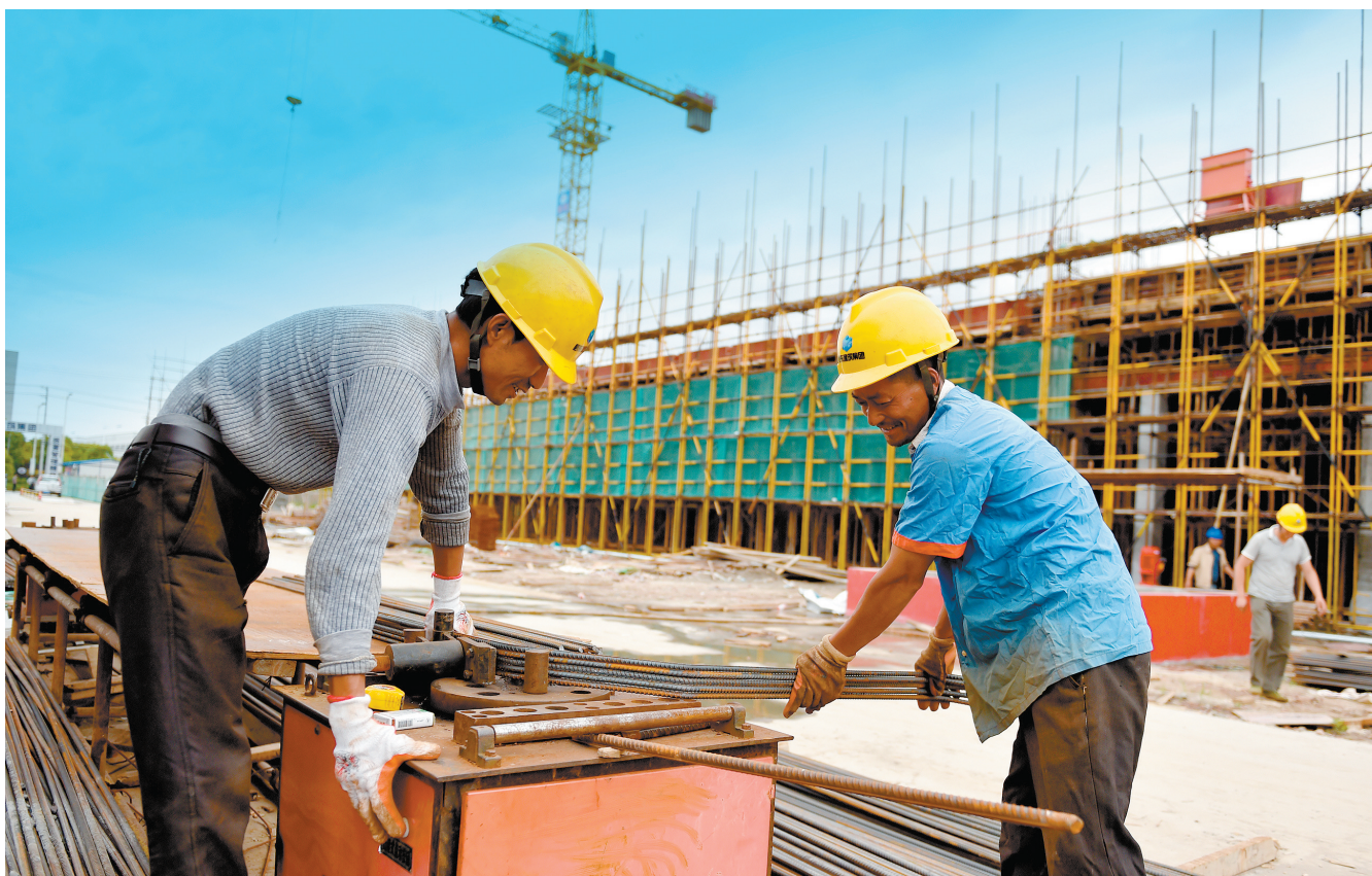
6月11日,盖天力药业二期施工现场,工人正在分区段进行流水作业。
