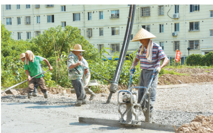
8月8日,汇龙镇台角小区小游园加紧建设。据悉,该小游园占地5000平方米,总投资200万元,预计年底完工。姜新春摄
