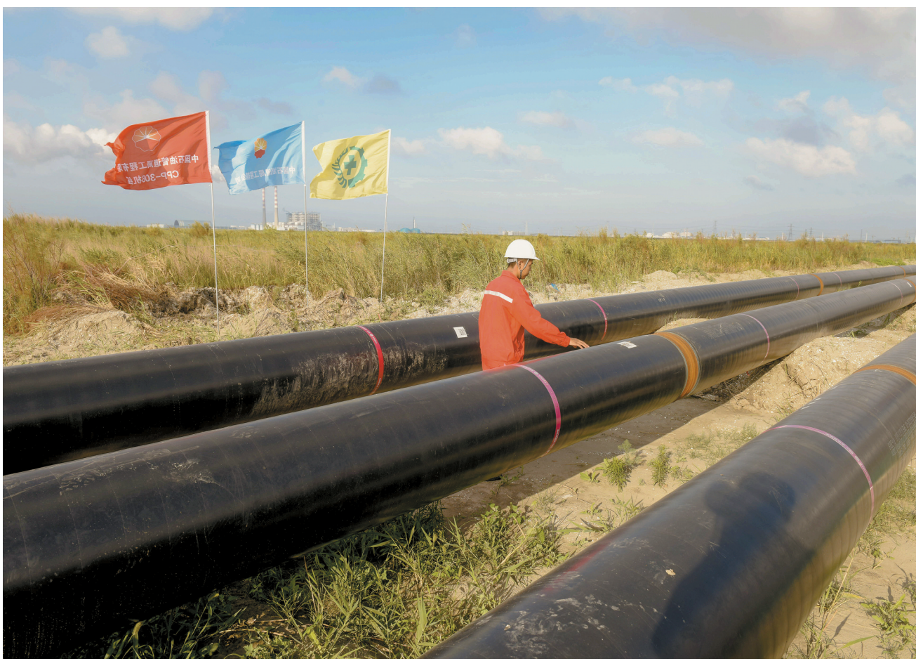
8月5日,位于吕四港经济开发区的启通天然气管线在建项目正在加紧建设,预计10月底建成投产,届时年输气量可达40亿立方米。
