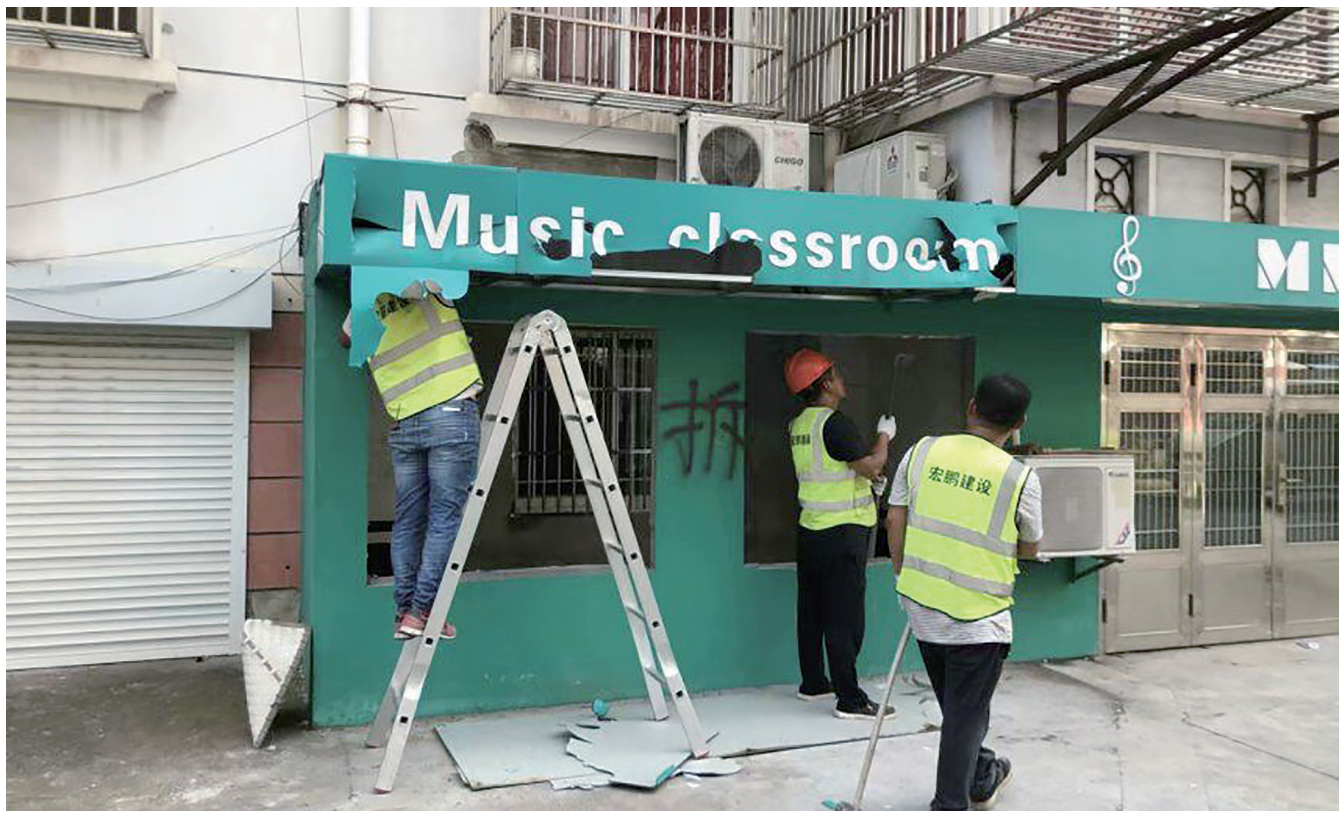
6月份以来,东洲新村社区工作人员通过入户走访、发放宣传资料、说服教育等多种方式积极做好拆违宣传工作。截至目前,辖区内帮拆和自拆的存量违建达230处。图为8月12日拆违现场。陆鸿健 姜新春摄
