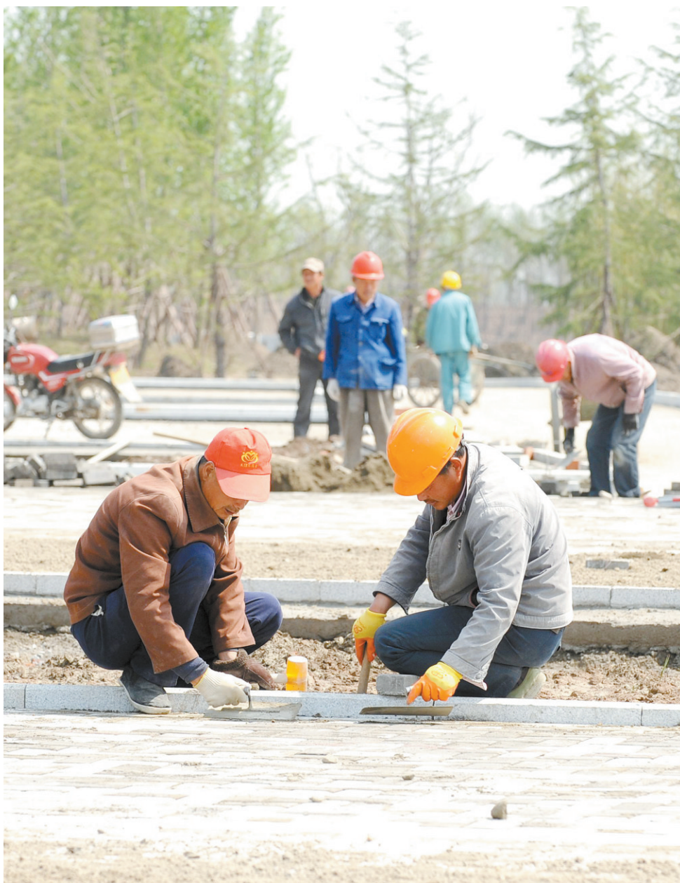
5月2日,位于城区东侧的丁巷港滨河体育公园铺设工程正加紧推进。该公园北起中央大道,南至世纪大道,东西宽约60米,南北长约4000米,总面积约24万平方米。分为一带两区四园,设有健身场地、慢行通道、球类场地等,可满足不同年龄和群体市民的健身需求。目前,土方工程基本完成,乔木绿化工程也已完成65%,广场、停车场等铺设工程正全面推进,预计10月1日左右完成主体工程。 郁卫兵摄
