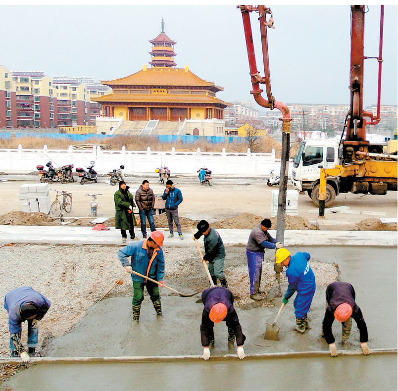
近日,市区灵秀公园最后一个停车场浇筑完成。因为施工人员在严寒中加紧施工。 郁卫兵摄
