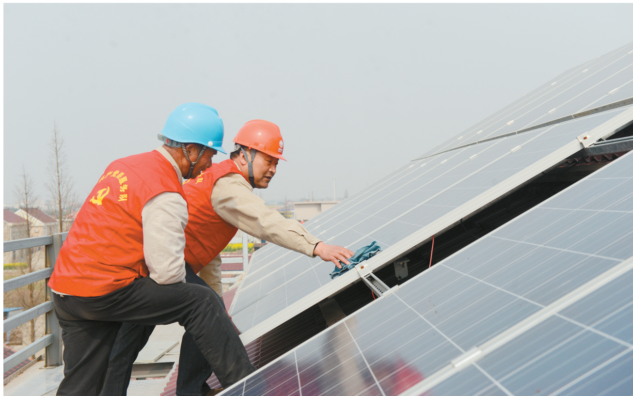
近日,市供电公司工作人员在汇龙镇合兴村一户家用分布式光伏发电站检修光伏发电板。近年来,我市家庭安装分布式光伏电站呈现出快速增长态势。截至目前,我市共有20多户家庭安装了家用分布式光伏电站,每户日均发电量为35度。潘杨摄
