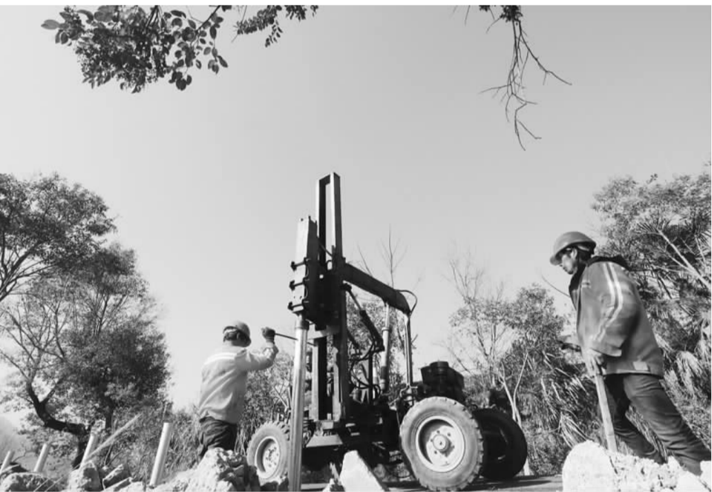
连日来,县公路管理局对小金线落差高的路段实施钢质护栏更新、安装工作,将新安装护栏2500余米。据悉,小金线实施大中修后,在连头岭、马头岭两处实施了限高3.1米通行。
