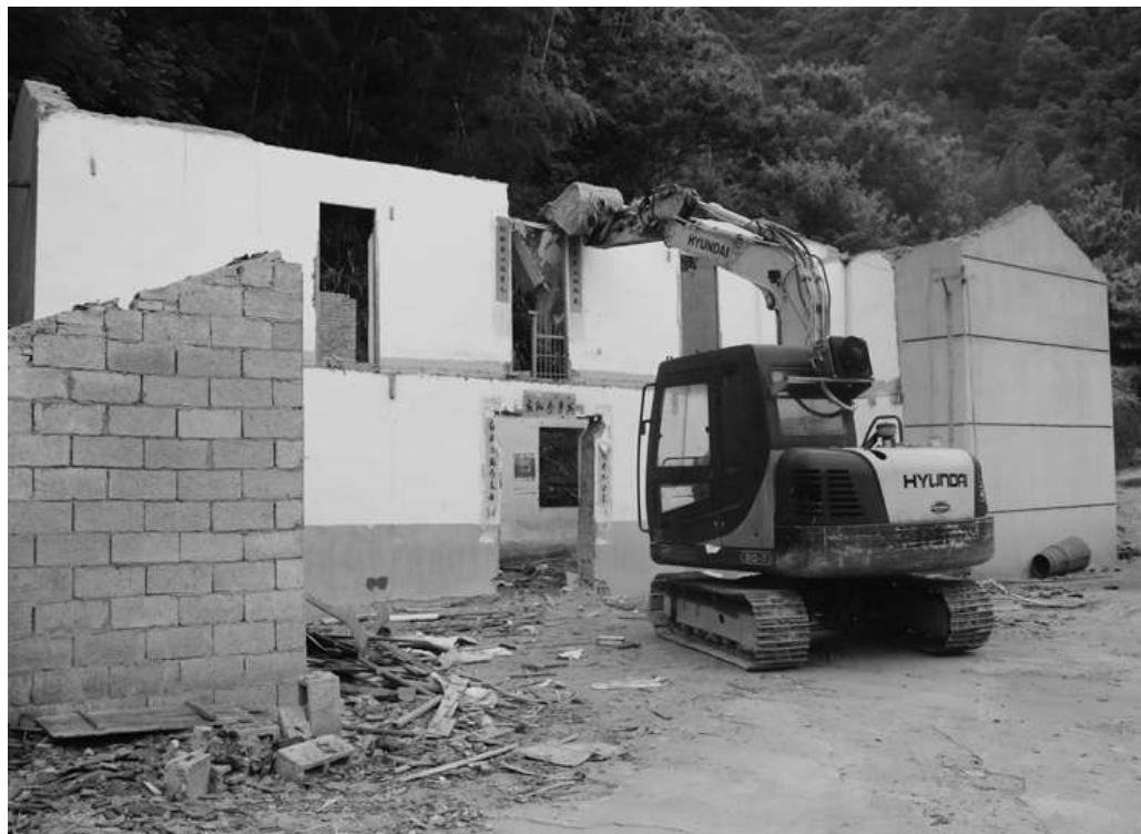
近日,金竹镇兰蓬村天门岙自然村完成整村拆除,拆后可复垦3亩多土地。
