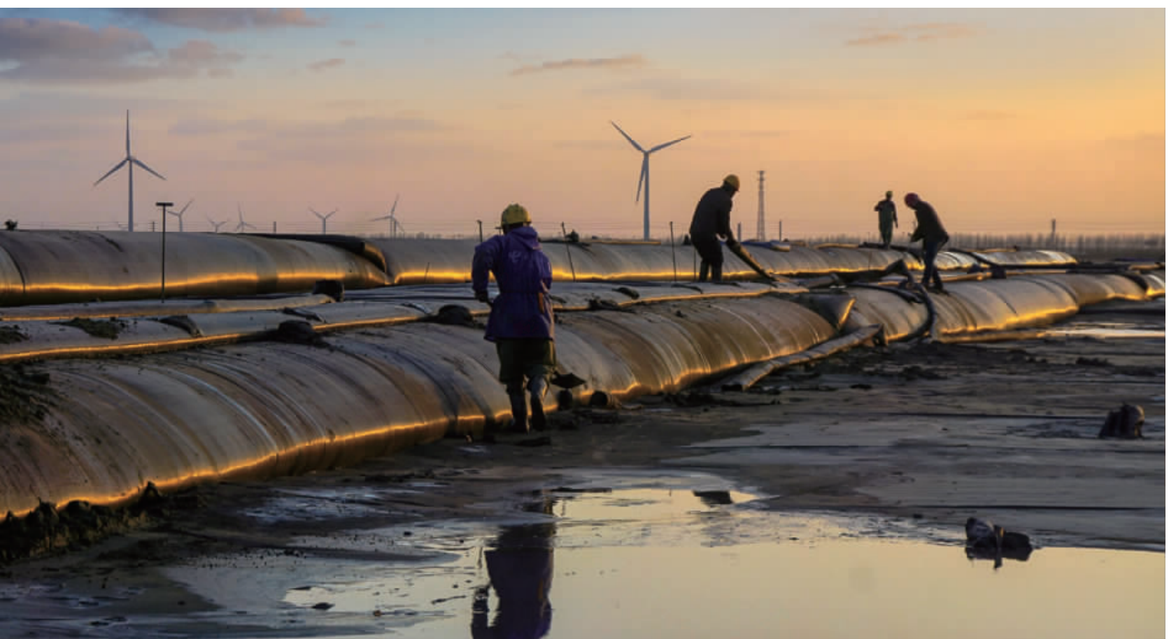
前天,工程人员正在洋口临港工业三期进行15万吨级航道疏浚工程纳泥区围堰施工。该项目总投资约11.41亿元,为国家重点工程,目前,航道疏浚工程已开工,先期需准备的3000万土方疏浚纳泥区已在洋口临港工业三期围堰区内建筑围堰,纳泥区围堰施工于下月份完成。 特约记者 陈建明 摄
