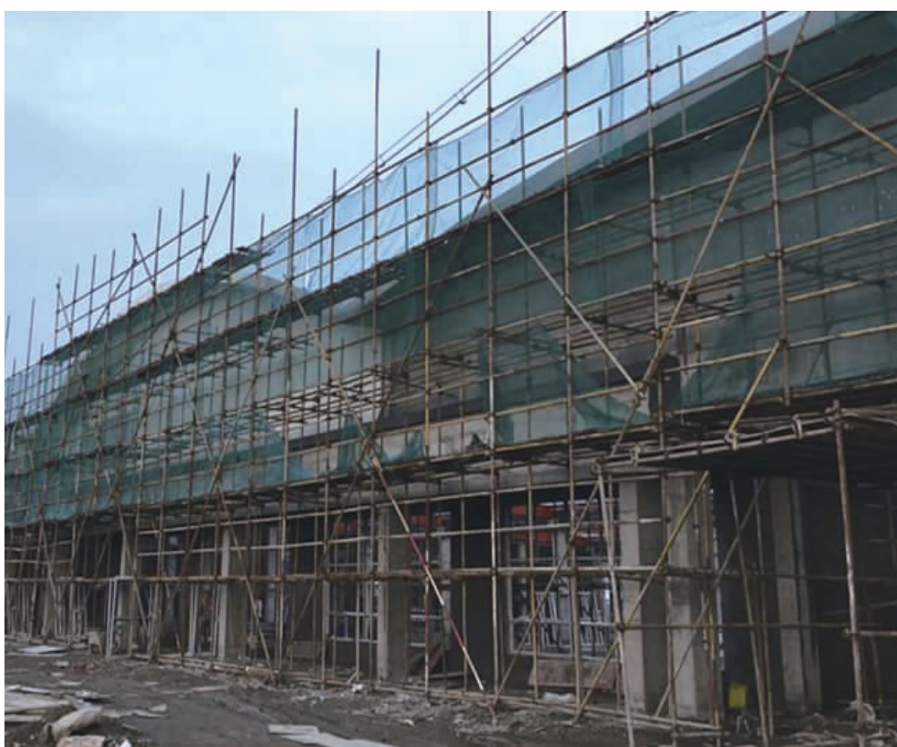
位于沿海经济开发区,由南通金岭岛投资发展有限公司投资1.5亿元建设的小洋口海鲜大排档项目,占地24亩,总建筑面积1.2万平方米,主要建设4栋餐饮建筑和1栋商业建筑。目前主体建筑工程已经完成60%,计划今年年底竣工。
