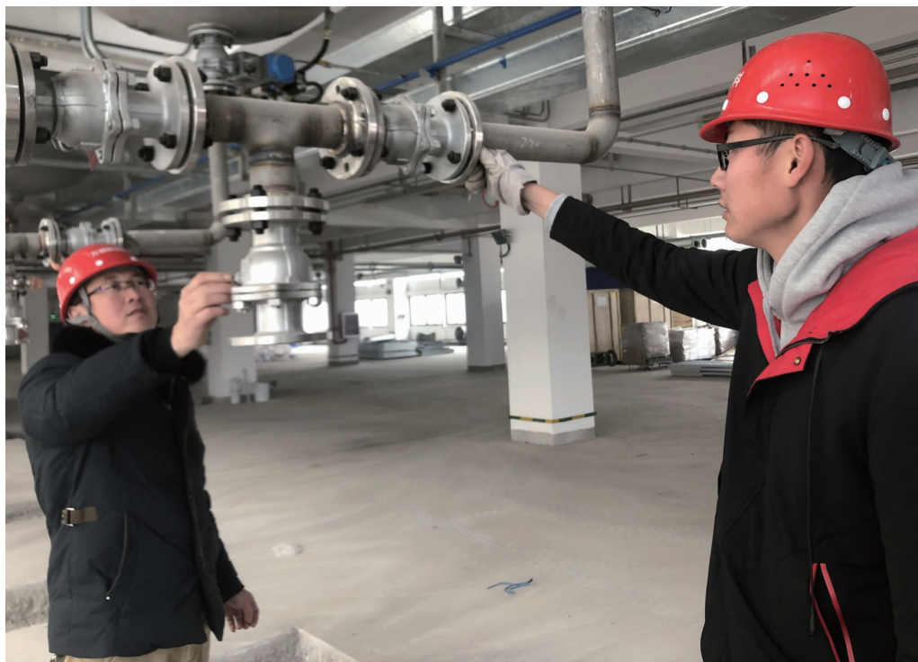
总投资10.2亿元的万博新材料项目将分两期建设,一期工程包括1栋办公楼、3个生产车间、仓库、罐区以及配套辅助用房,主要生产水性涂料、水性树脂、UV光固化涂料以及卷材涂料等系列产品,预计4月份投产,全面达产后年销售额将突破16亿元。全媒体记者 吴慧 单佳凯 冯益军 摄
