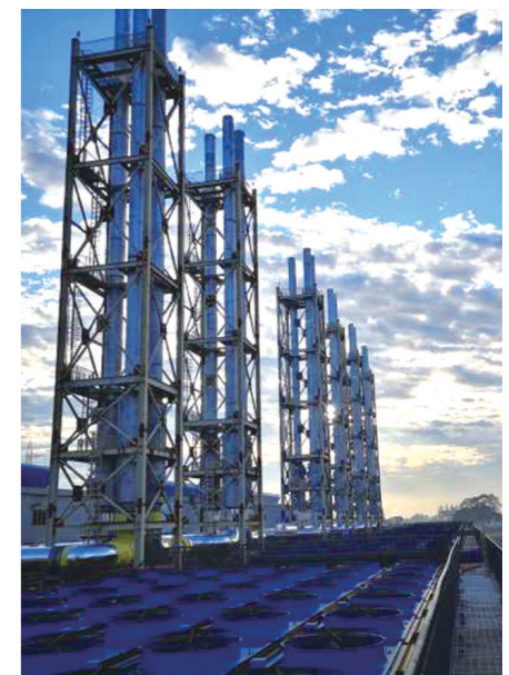
中车资阳公司承建的孟加拉国最大单体重油电厂——阿苏岗杰150兆瓦重油电厂
