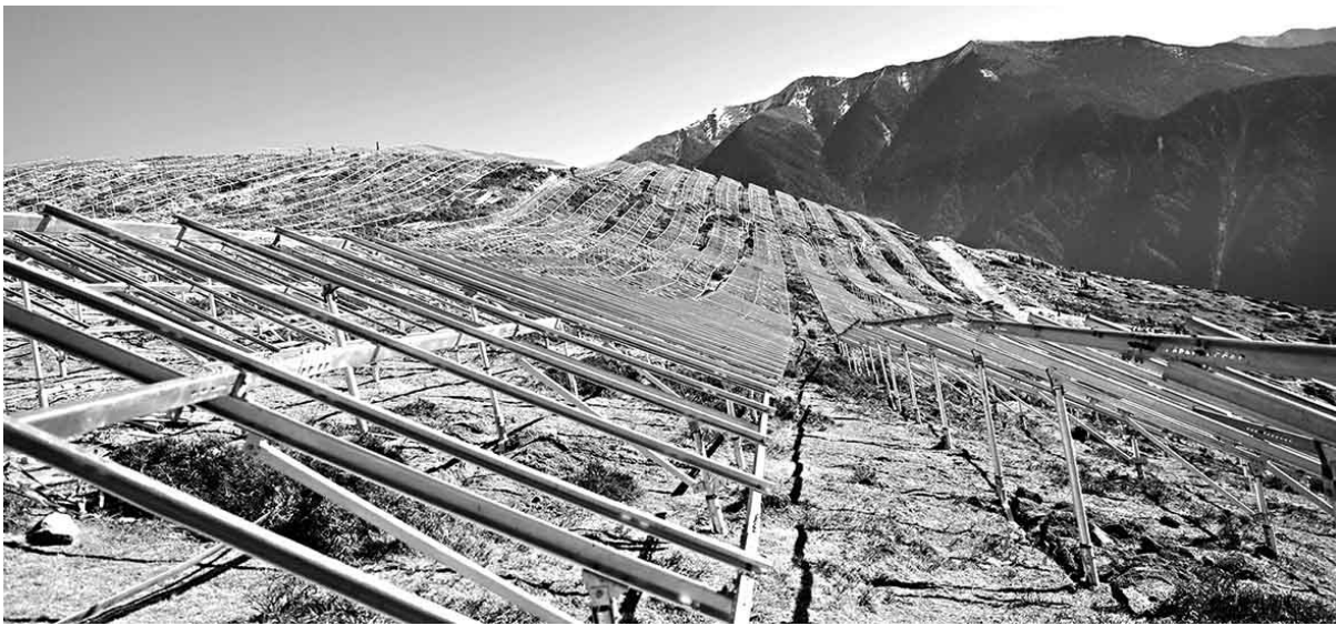
正在建设中的光伏扶贫电站
