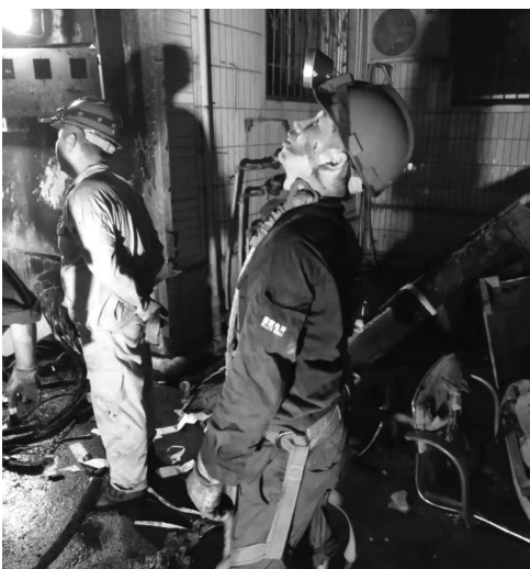
电力维修人员正在抢修被烧毁的分流箱及电表箱
