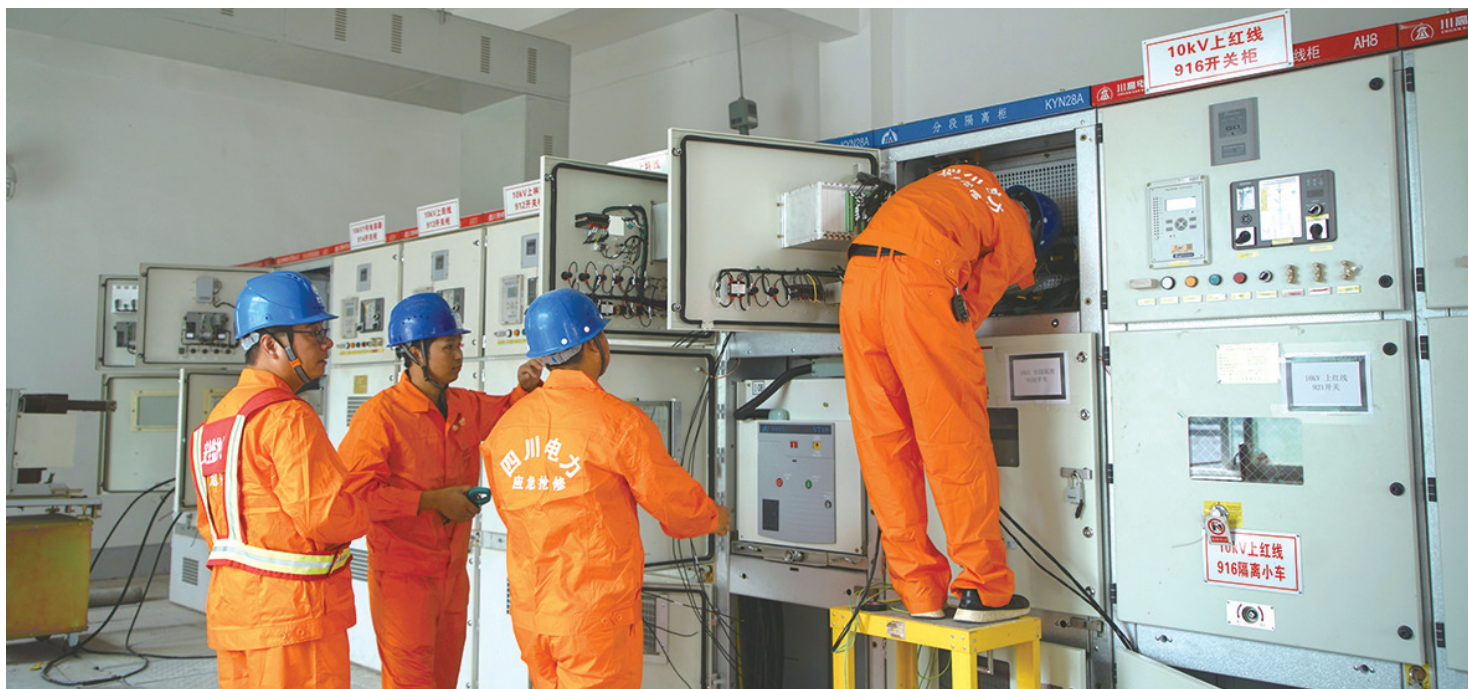
10月12日,电力施工人员正在35千伏上田坝电站内进行二次接线(图片由国网四川省电力公司提供)
