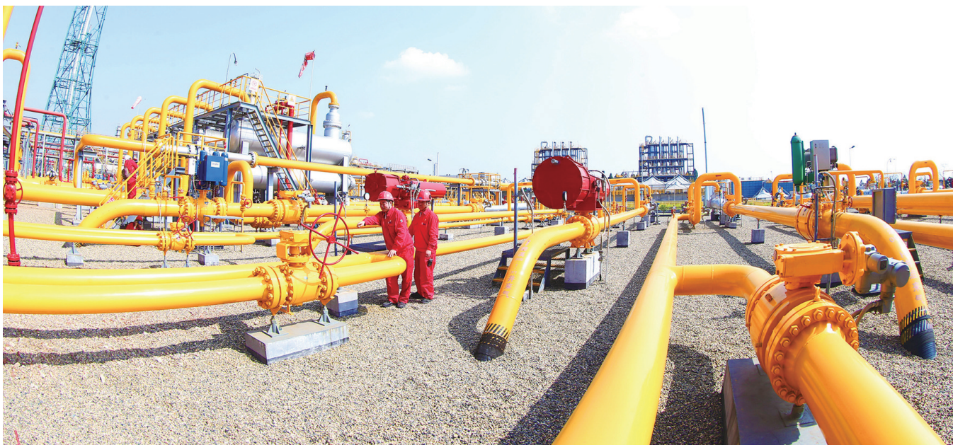
天然气生产现场(图片由中国石油西南油气田公司提供)
