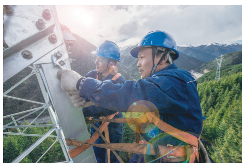
4月16日,国网成都供电公司援建者在“三区三州”阿坝夹壁至马塘110千伏线路新建工程N84塔位开展组塔工作。(邹耀军 摄)
