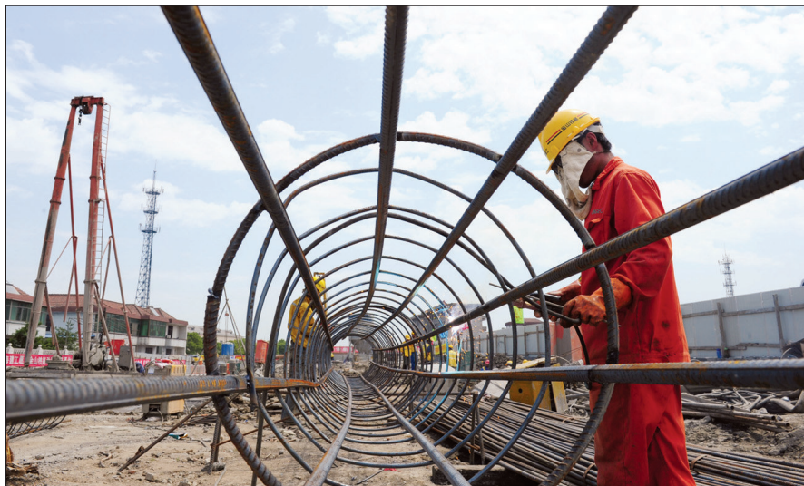
金山铁路支线大叶公路中桥工程正在加紧施工中。该工程地处叶榭镇境内,为下穿式立交结构,主体结构长约360米,设计为双向机动车和非机动车道,由上海建工(集团)公司施工,计划于今年10月竣工。图为施工现场。 通讯员 曹细平 记者 岳诚 摄
