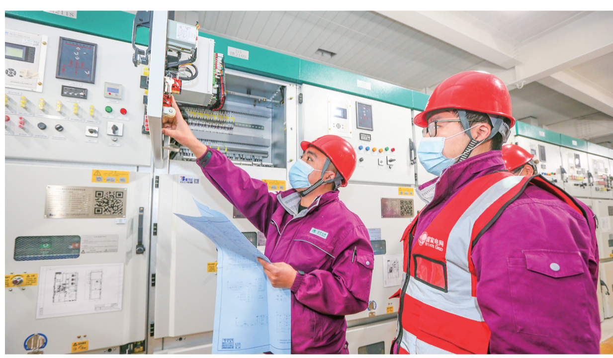
供电公司工作人员在车峰110千伏输变电工程现场调试设备。
