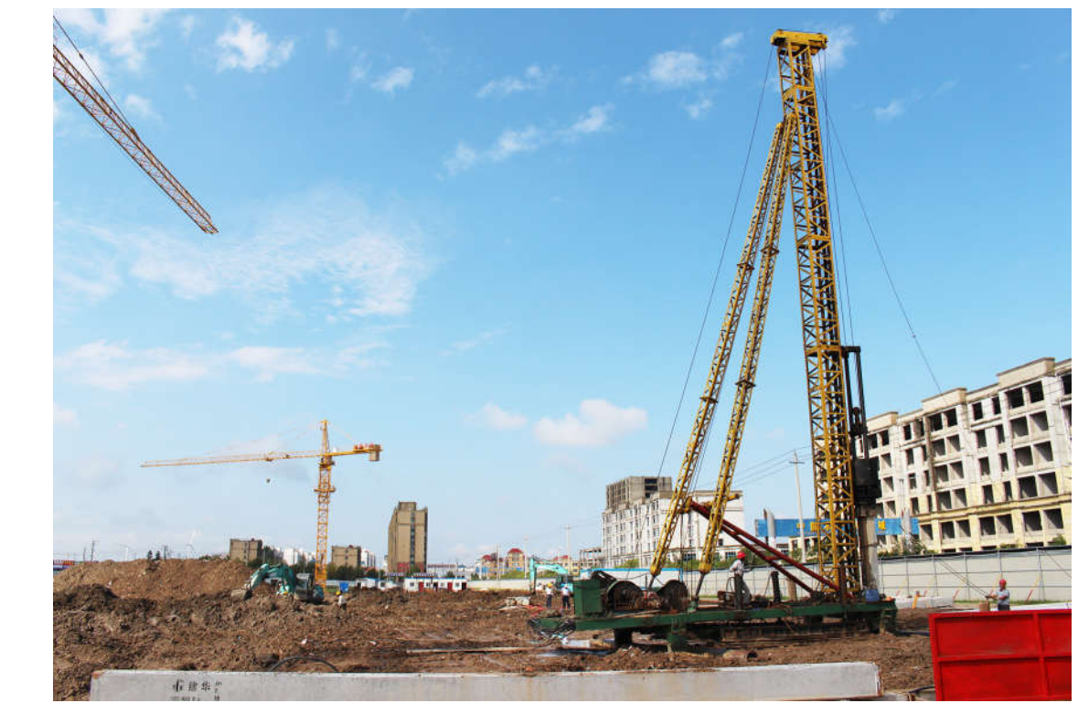
近年来,黄沙港镇围绕打造渔港特色小镇,建设黄海湿地旅游新坐标的目标定位,完善提升规划,聚集资源要素,强势组织推进,渔港小镇建设步伐明显加快。图为总投资6亿元的渔港风情广场项目施工场景。王荣 摄
