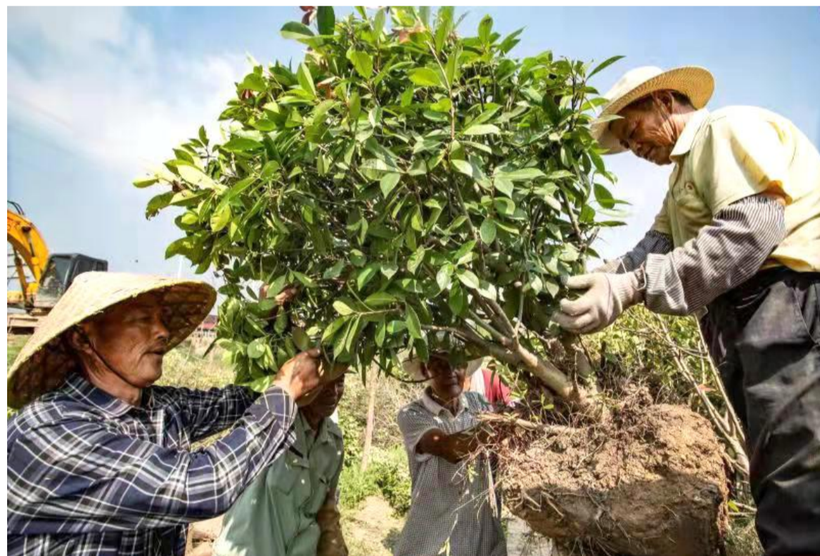
连日来,在射阳渔港小镇“精神堡垒”建设工地上,工人们加紧种植树木,拆除木制建筑,为下一步建设长32.5米、宽6.5米的标志性渔船建筑拓宽场地。图为工人们正在移植树木。
