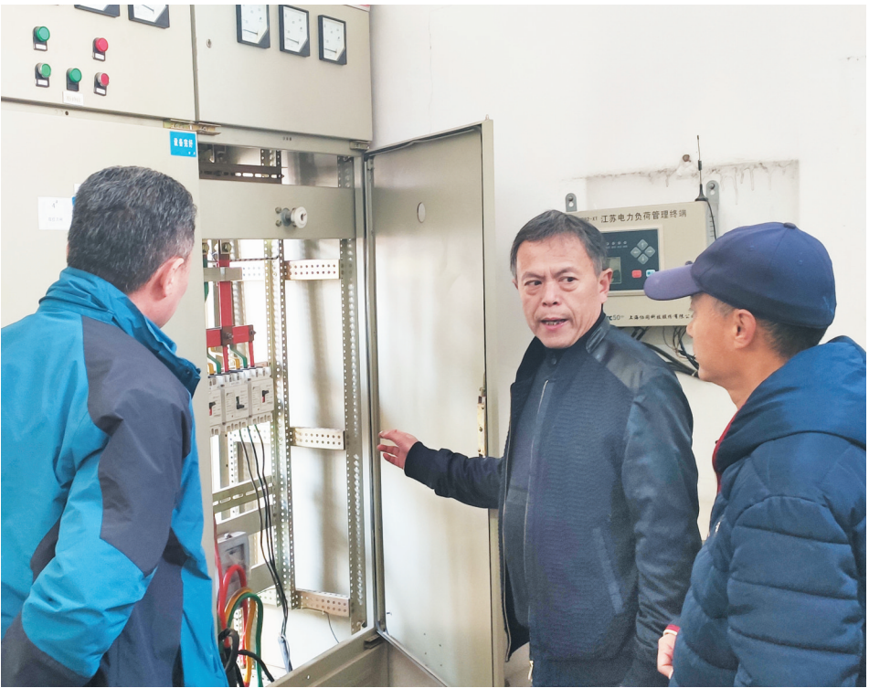
临 近 年 终,生活 服务 经营 总公司 组织 相关 人员 对 变电 所 进行 安全 大 检查,确 保 供电 安全。 图 为 该 公 司 工 作 人 员 在 检 查 配 电 箱。 通讯员 陈超然 摄
