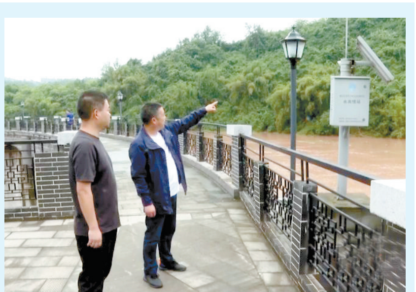
水库大坝安全监测系统水雨情站
